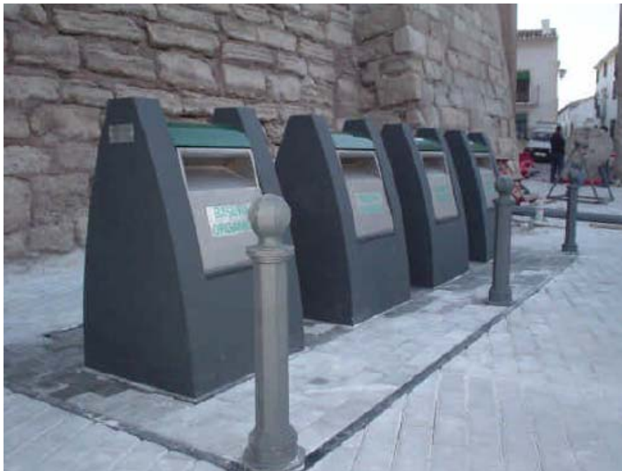
Fig. 15 Equipamiento hidráulico para recogida de desechos sólidos.
